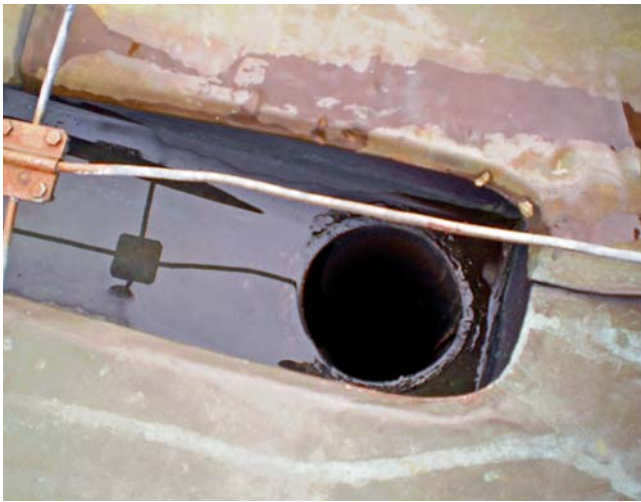
Fot. 12. | Wlot górny spustu wody opadowej (przed renowacją)
