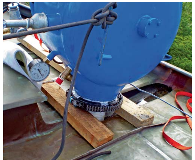
Fot. 11. | Inwersja rękawa do wnętrza przewodu DN150 z bębna inwersyjnego przy pomocy ciśnienia powietrza ok. 0,3 bar
